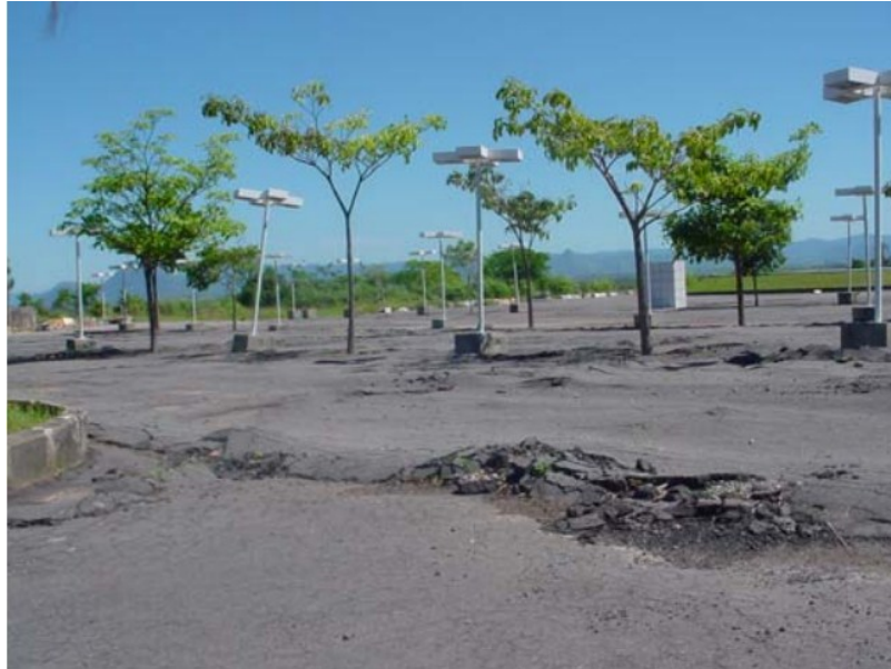
Figura 6 - Exemplo do uso inadequado de escória de aciaria - fissuração longitudinal irregular em pátio de estacionamento. Fonte (MENDONÇA, 2006)
